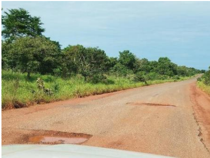
Photos 27:PK153-nid de poule profond et stagnation
