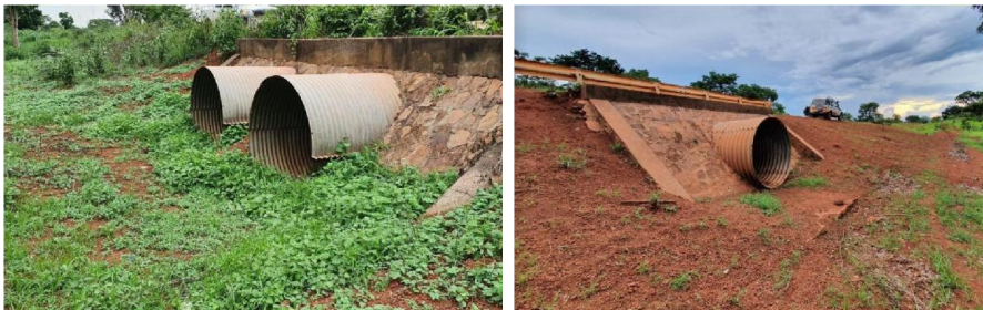
Photos 39: 2 Buses métalliques de diamètre 2000 (PK
