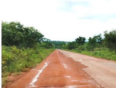
Photos 21: PK134-épaufure de côté gauche de la chaussée
