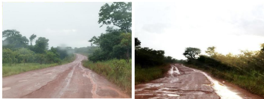
Photos 16: PK53 et PK60, ravinements longitudinaux
