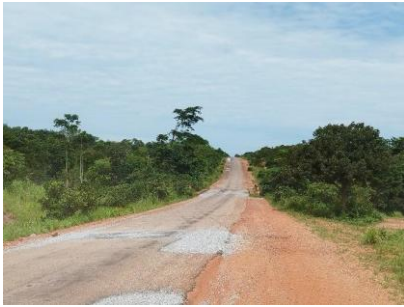
Photos 29 : PK211-dénivellation de l'accotement
