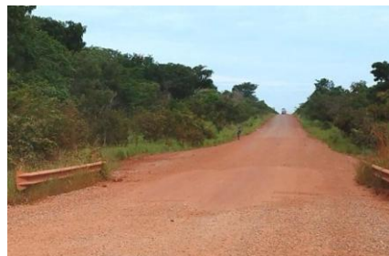
Photos 19: PK192-arrachement sur une dizaine de mètres
