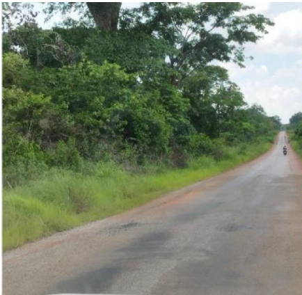
Photos 6:PK8.4-ressuage généralisé sur la chaussée
