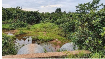
Photos 42: 2 Buses métalliques de diamètre 3000 (PK 108)
