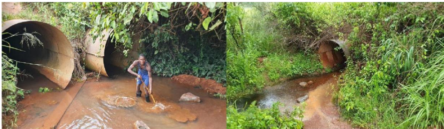
Photos 37: 2 Buse métallique de diamètre 2000
