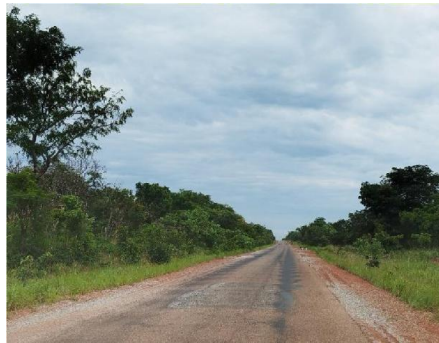
Photos 32:PK178-ressuage des deux côtés de la chaussée
