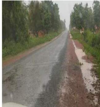
Photos 44: Fossé trapézoïdal en terre
