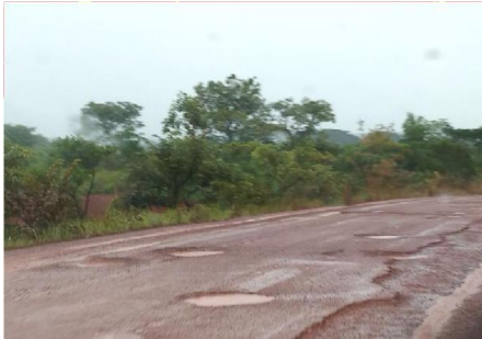
Photos 12: PK53, nids de poule de grande profondeur et de faible surface mais en nombre
