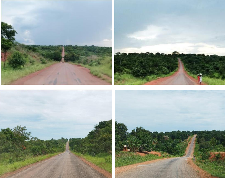
Photos 35: Pentes accentuées et points bas à rehausser au niveau des PK 103,106,107 et 225+500
