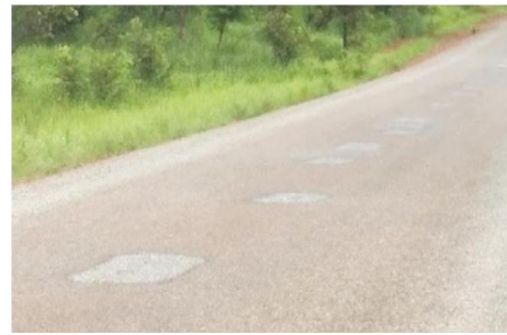
Photos 4: PK39-nids de poules rebouchés
