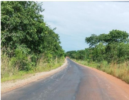
Photos 31:PK160-ressuage sur la totalité de la route
