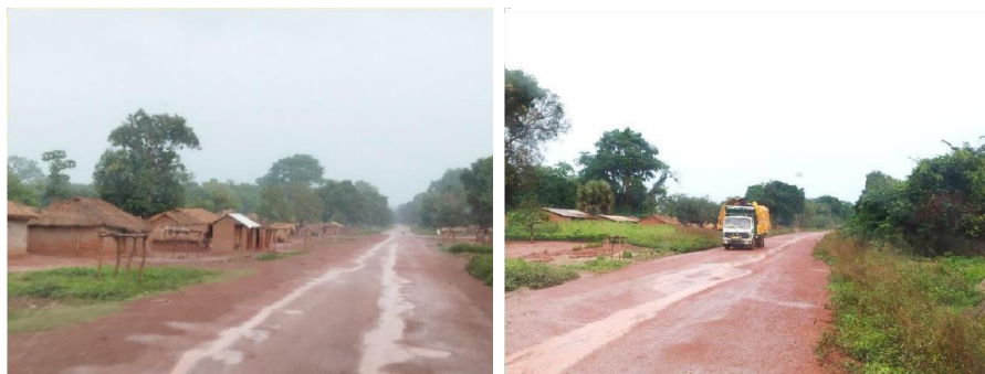
Photos 15: PK4 et PK 50 : ravinement longitudinal sur l'axe et les rives de la chaussée
